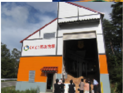
木質バイオガス化発電設備
